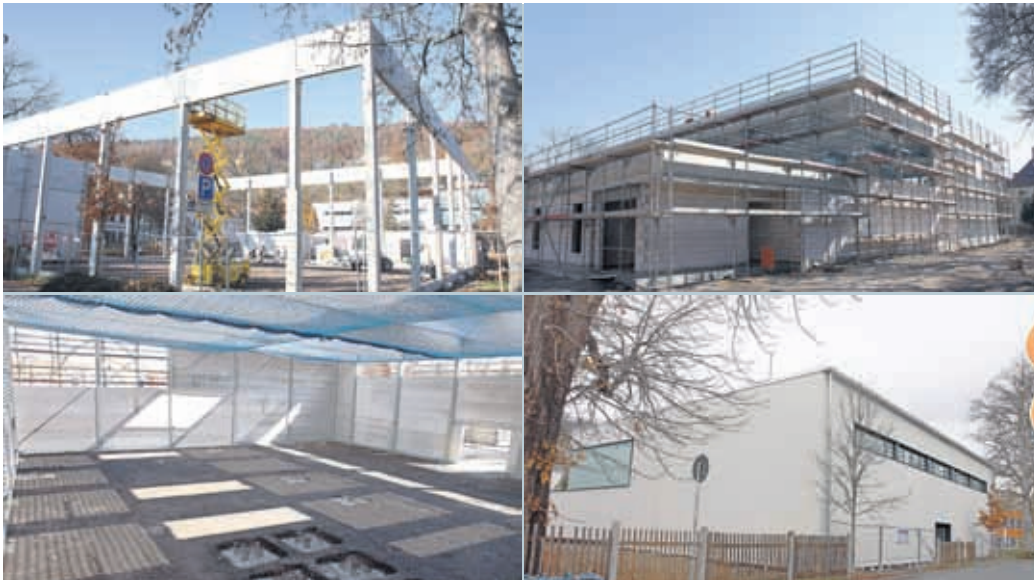
Die neue Zwei-Feld-Halle bietet den Schülern am Gymnasium Fridericianum in Rudolstadt künftig eine sportliche Heimat – Die Bilder dokumentieren den Bau im November 2011 und März 2012 sowie heute kurz vor der Fertigstellung
